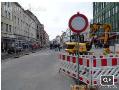
Auf dem dritten Teilstück der Karl-Marx-Straße wird zunächst auf der rechten Straßenseite in Fahrtrichtung gebaut, der Verkehr wird links an der Baustelle vorbeigeführt. (Foto: Sylvia Baumeister)
